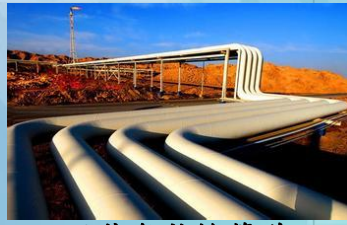
天然气长输管道
